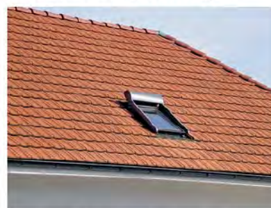
Exemple d'élément en saillie (caisson de store) endommagé sous l'action d'un glissement de neige.
