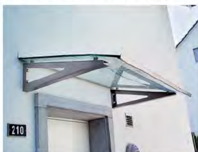
Exemple d'avant-toit cassé par de la neige ayant glissé du toit.
