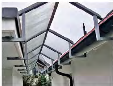
Exemple de toit intermédiaire endommagé par de la neige ayant glissé du toit principal.
