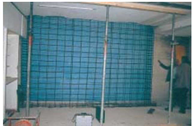
9/2 Die Bewehrung von Stahlbetontragwänden ist verhältnismässig einfach, muss aber sehr sorgfältig gestaltet und verlegt werden. Das Bild zeigt eine kapazitätsbemessene duktile Tragwand mit Rechteckquerschnitt, die in ein bestehendes Gebäude eingefügt wurde (Schweiz 1999).
