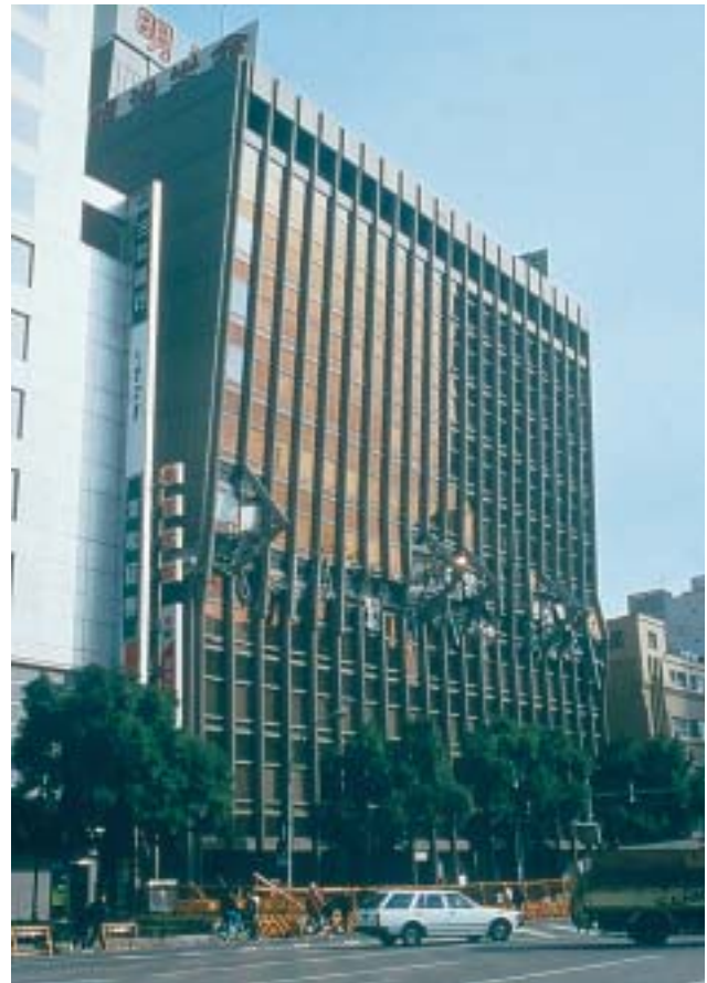
5/2 Auch in diesem Bürogebäude hat ein Obergeschoss versagt. Der darüber liegende Teil des Gebäudes ist abgesackt, und er hat sich dabei etwas verdreht und nach vorne geneigt.
