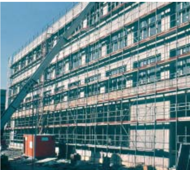
8/1 Der Übergang der Stahlbetontragwand in den Rahmen entspricht grossen Sprüngen bei Steifigkeiten und Widerständen (Schweiz 2001).
