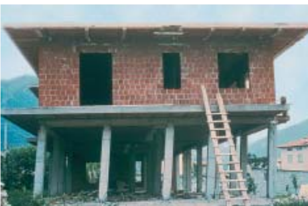
4/1 Dieser Stützenmechanismus im Erdgeschoss eines im Bau befindlichen Gebäudes führte nur ganz knapp nicht zum Einsturz (Friaul Italien 1976).
