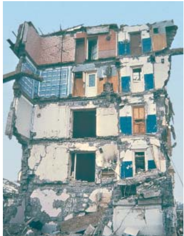
22/2 22/3 Auch bei diesen Wohnhäusern bestanden die Decken nur aus vorgefertigten Platten, die unter sich und mit den Wänden ungenügend verbunden waren (Armenien 1988).
