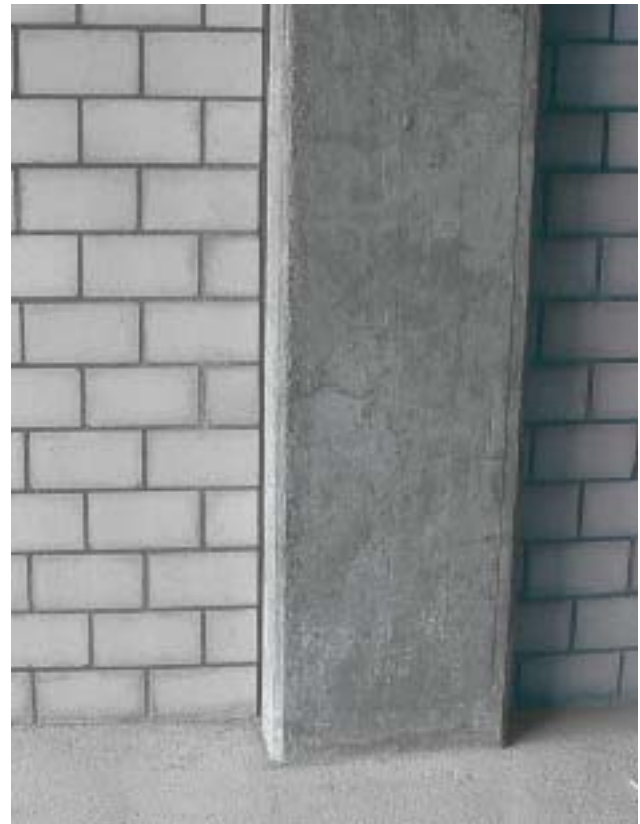
15/1 Hier wurde zwischen der Mauerwerkswand und der Stahlbetonstütze eine – wohl wesentlich zu dünne – vertikale Fuge angeordnet (Schweiz 1994).
