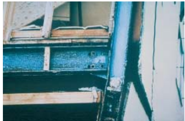
19/2 Hier versagten die Schrauben in der Verbindung des Trägers zur Stütze (Kobe Japan 1995).
