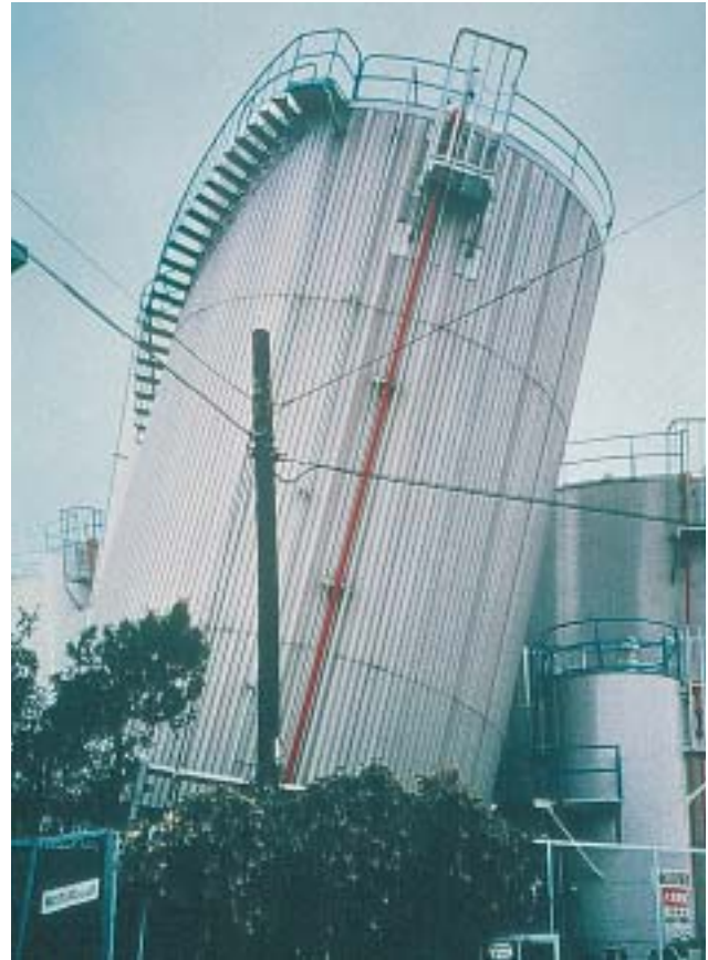
30/4 Auch dieser Tank hat sich schief gestellt. Als Ursache wurde die Verflüssigung von aufgeschüttetem sandigem Boden festgestellt (Kobe Japan 1995).
