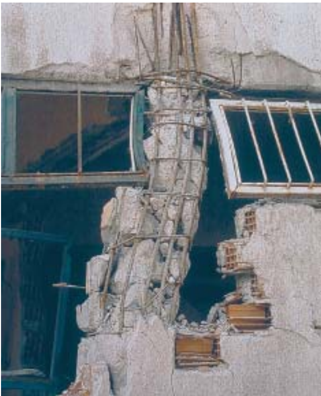
17/5 Die Stützen wiesen eine mangelhafte konstruktive Durchbildung auf (Bügel mit 90°- anstatt 135°-Haken und mit entsprechendem Verankerungsbruch, vergleiche Grundsatz 25). Ohne die ungünstige Wirkung der eingefügten Wände hätte sich diese Stütze aber viel besser verhalten (Izmit Türkei 1999).
