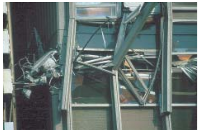
5/3 Diese Nahaufnahme zeigt das zerquetschte Obergeschoss des Bürogebäudes (Kobe Japan 1995).
