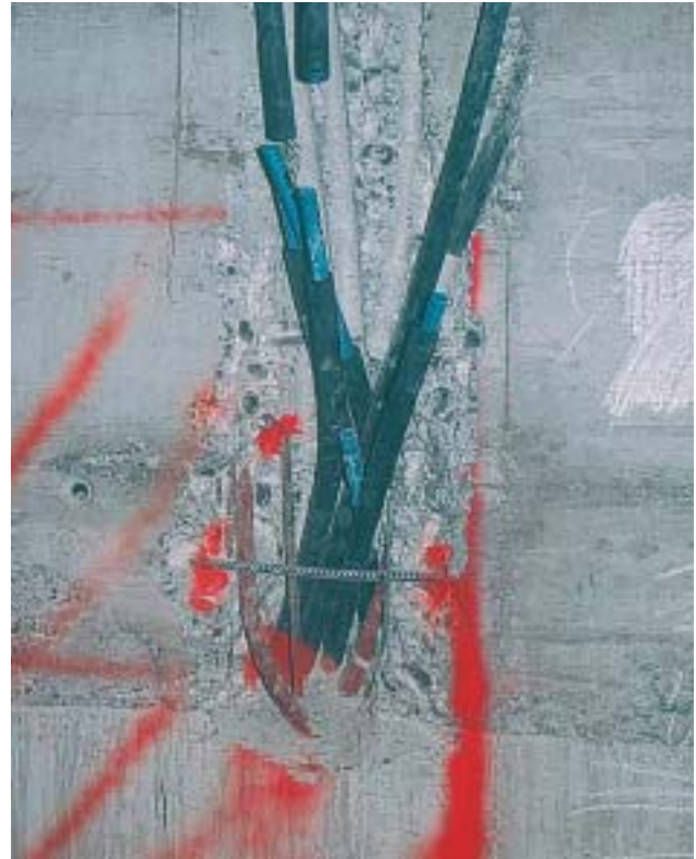
26/5 Auch solche ungeplant verlegte Leitungsstränge können das Erdbebenverhalten einer Stahlbetontragwand beeinträchtigen (Schweiz 2001).
