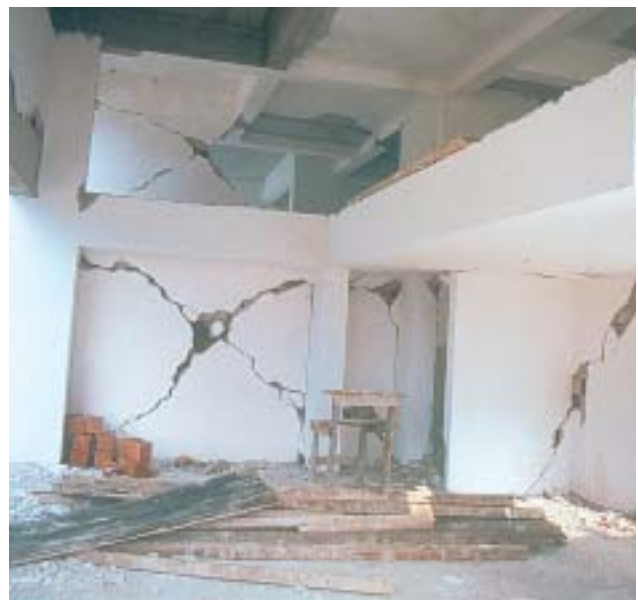
11/4 Das sind typische Kreuzrisse in Mauerwerkswänden, die in massive Stahlbetonrahmen eingefügt wurden (Izmit Türkei 1999).
