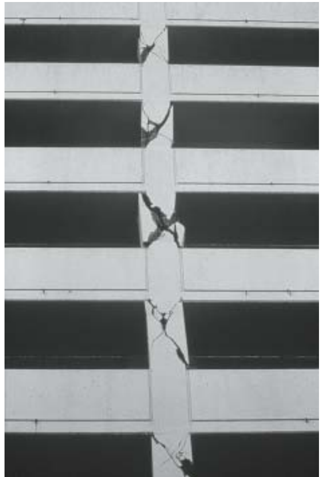
16/1 Die Kreuzrisse und Schubbrüche in den kurzen Stützen eines Parkhauses haben beinahe einen Einsturz bewirkt (Northridge Kalifornien 1994).
