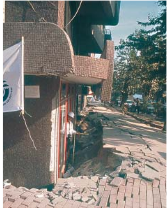
30/1 Dieses Gebäude ist infolge Bodenverflüssigung um etwa 1 m gleichmässig abgesunken. Das verdrängte Bodenmaterial hat die Strasse aufgewölbt (Izmit Türkei 1999).
