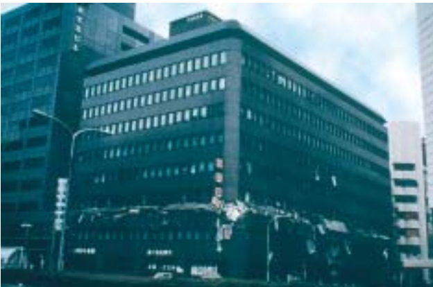
5/1 In diesem Geschäftshaus ist das dritte Obergeschoss verschwunden. Der darüber liegende Teil ist um ein Stockwerk abgesackt (Kobe Japan 1995).
