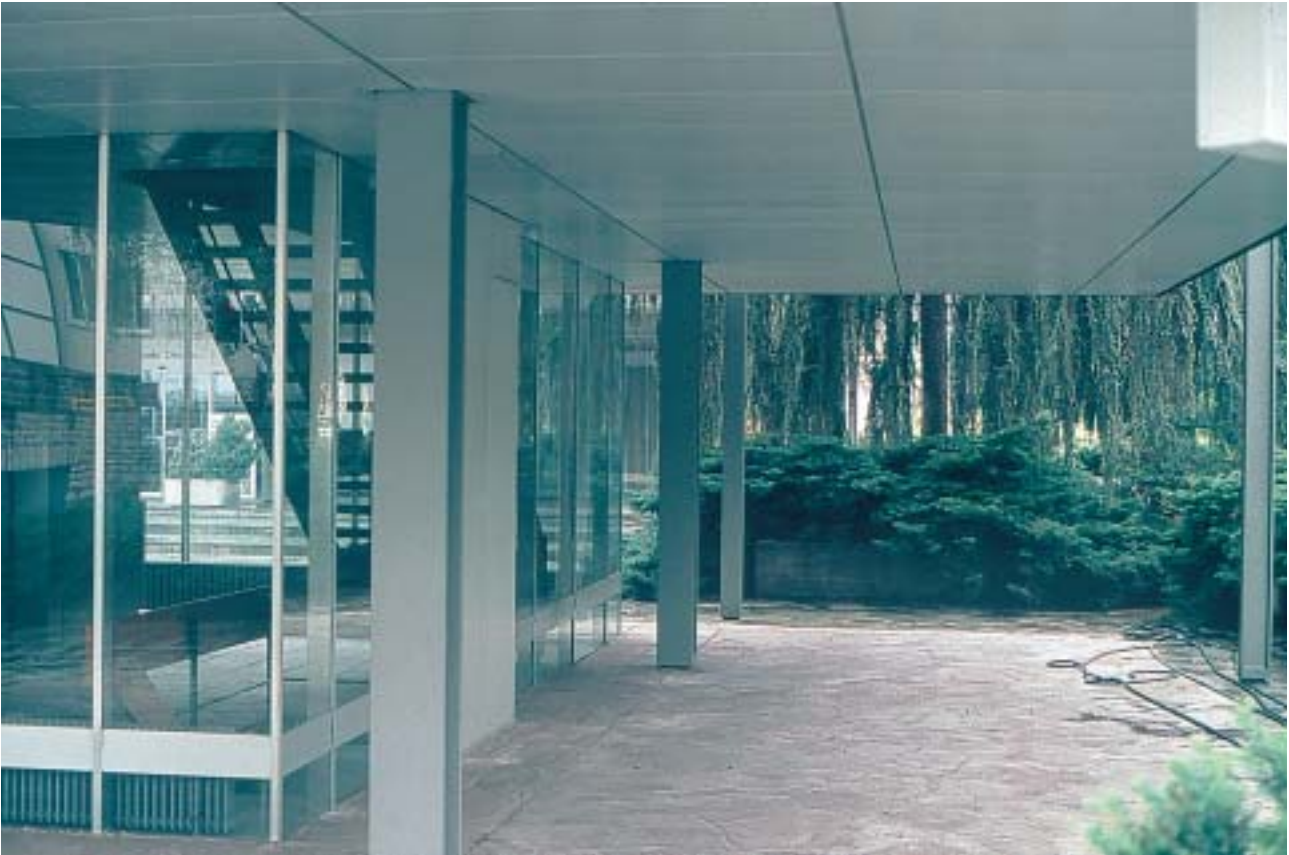
4/9 Bei solchen bestehenden Gebäuden ist zu vermuten, dass sie schon bei einem relativ schwachen Erdbeben einstürzen (Schweiz 2000).
