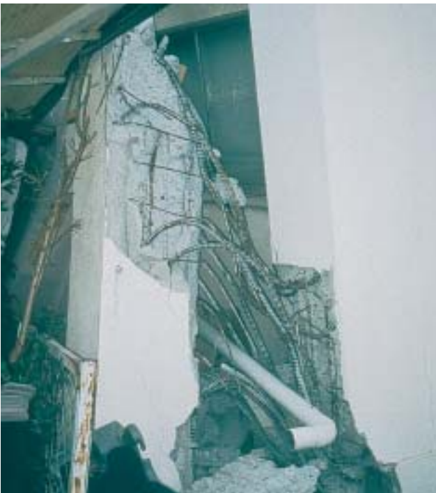
4/6 ... und das sind die Überreste der Erdgeschossstütze an der linken vorderen Ecke des Gebäudes (Kobe Japan 1995).
