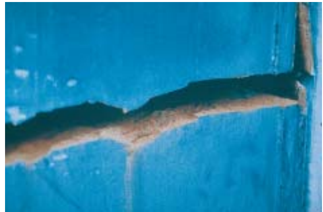
19/5 19/6 Am Fuss der Stütze eines Hauptrahmens in einem Hochhaus aus Stahl bildete sich ein breiter Riss (rechts im oberen Bild). Als Ursache wurden hohe zyklische Normalkräfte, Auswirkungen der Dehngeschwindigkeit, Materialfehler, Schweißfehler und Temperaturwirkungen in Betracht gezogen (Kobe Japan 1995).
