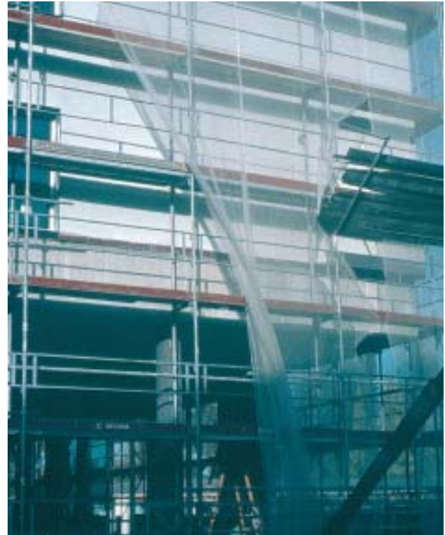
8/2 Bei Erdbebeneinwirkung bewirkt die (auskragende!) Stahlbetonwand (hinter dem Vorhang) hohe Zusatzbeanspruchungen in der ohnehin stark belasteten Stütze des Erdgeschosses (Schweiz 2001).
