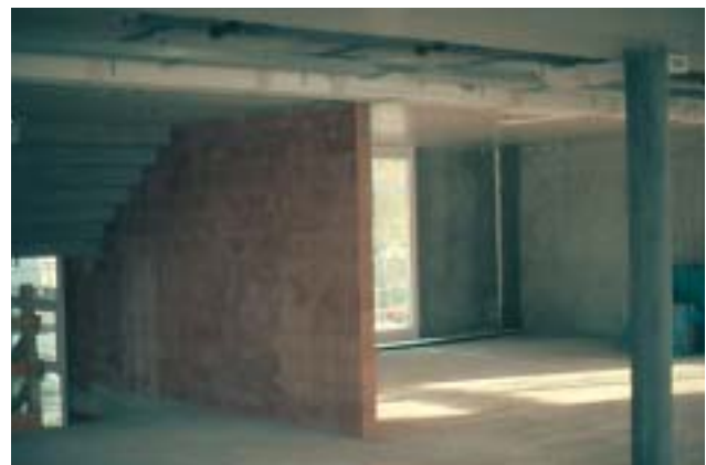
10/1 Diese tragende Treppenhauswand wird bereits bei einem relativ schwachen Erdbeben zerstört werden. Ein Totaleinsturz des Gebäudes dürfte die Folge sein (Schweiz 2001).
